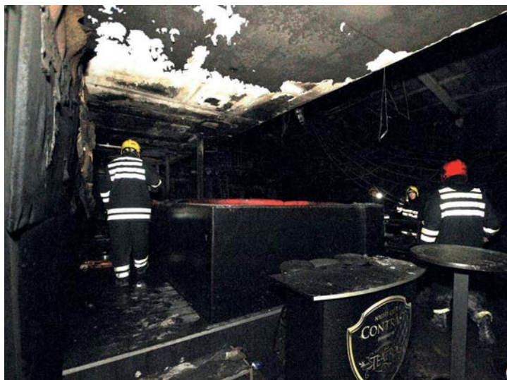
NASTRADALI I LOKAL: Posle požara
